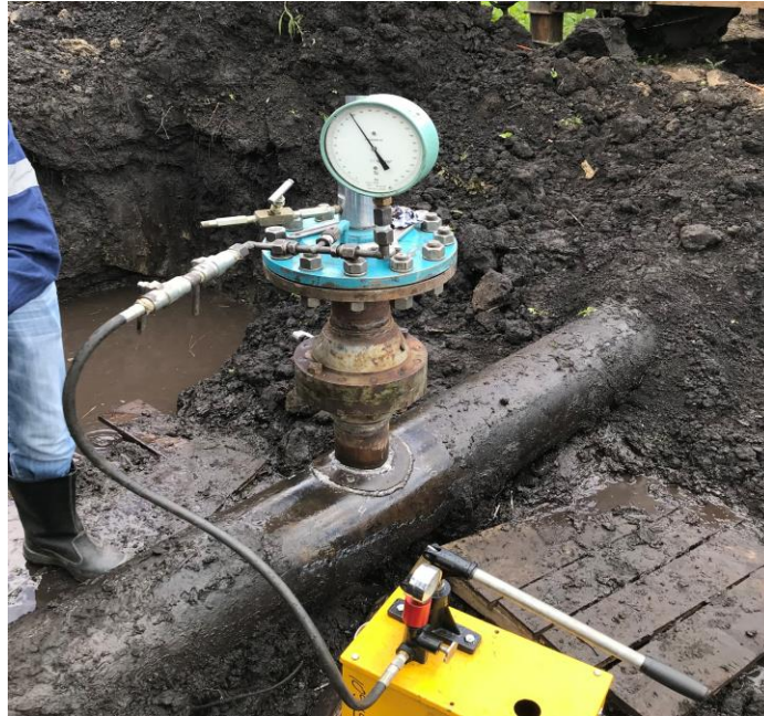
Рис. 2. Проведення гідравлічних випробувань вузла відводу DN 100 типу "Відвідний патрубок з підсилюючою накладкою" на газопроводі DN 250
